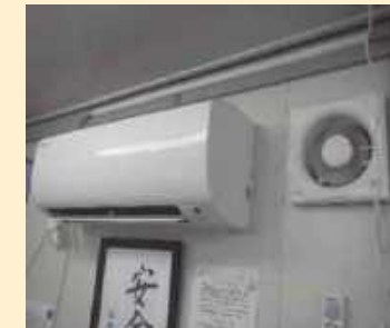
扇風機や換気扇とエアコンを併用
