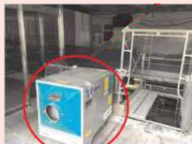
集塵機を設置し室内の換気を実施
